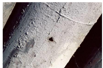
Stahlvollrohr mit erheblicher Korrosion/Lochfraß
