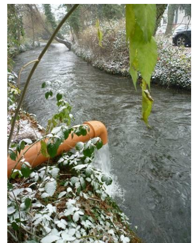
Ablauf gereinigten Grundwassers
