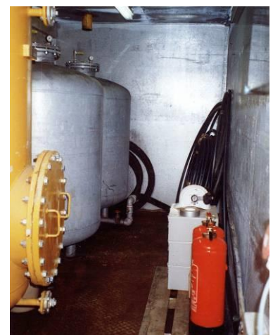
Wasserreinigungsanlage mit 2 Wasseraktivkohlefiltern (je 1.000 l)
