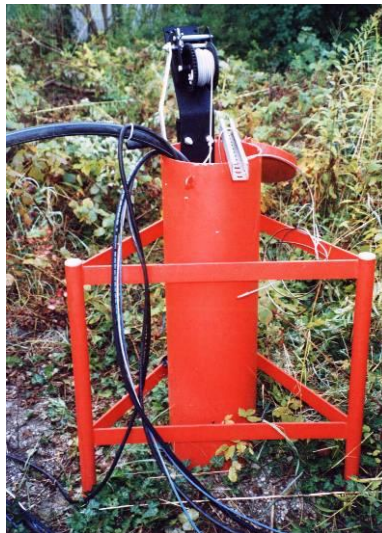
Sanierungsbrunnen mit eingebauter Pumpenmechanik zur dynamischen Phasenabschöpfung
