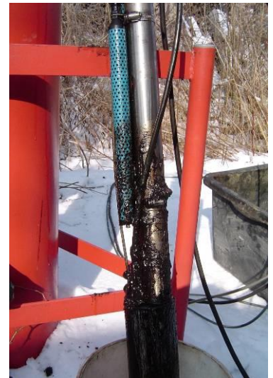
Kohlenwasserstoffpumpe mit verschmutztem Filtereinlauf und Schwimmer
